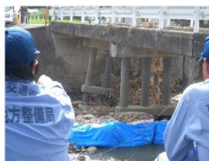
橋脚基礎洗掘による傾き被害状況 (矢掛町 古屋谷橋)
