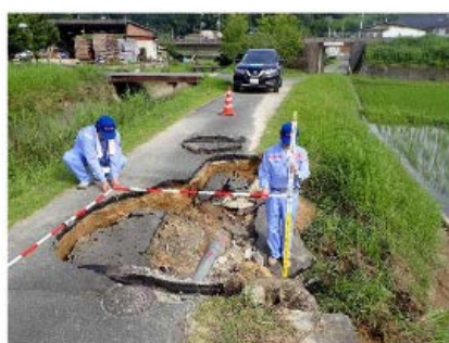
越水による堤防洗掘被害状況 (矢掛町 林田川)
