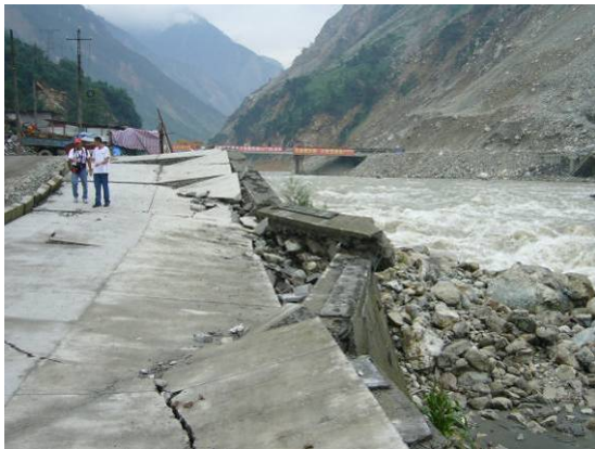
照片 17 斷層經過處因擠壓造成護岸推擠歪斜。人站於斷層跡上，其後方抬升約 2-3 公尺。
