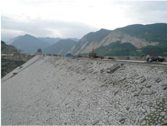
照片 1 紫坪鋪水庫壩頂外側護欄因地震震落於下游背水坡面。
