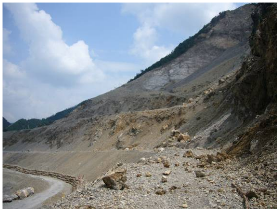
照片 41 茶坪河右岸肖家橋崩塌之崩崖，為一順向坡崩塌；照片中之平臺階段，為洩流後人工整平之平臺階段，預防坡面繼續崩滑。
