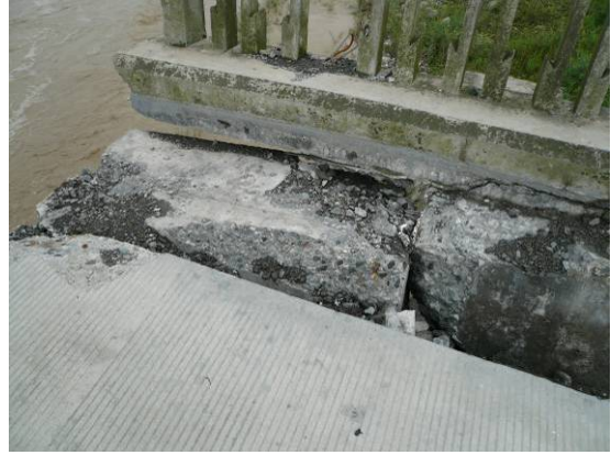
照片 48 小魚洞大橋因地震力作用造成橋板分離。
