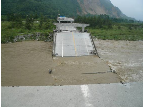
照片 47 因地震力作用造成小魚洞大橋橋板陷落河床。
