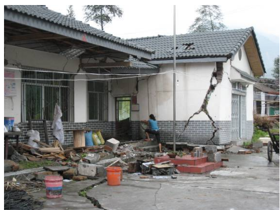
照片 46 斷層通過附近造成地板龜裂與房屋嚴重受損。
