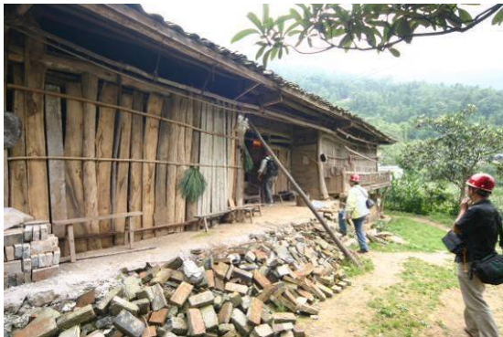
照片 37 位於新北川中學上方景家山之木造房舍，屬柔性結構，雖歷經 512 汶川地震衝擊，但仍大致完整無損，其前方磚砌之圍牆則因地震而倒塌。
