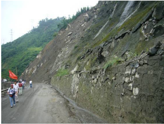
照片 9 國道 213 線上邊坡採鋼絲鐵網水泥噴漿處理，與遠處兩相對照，已發揮噴漿處理之功效。但因地震導致部分隆起，與地面脫離，未來容易因雨水侵蝕造成整片鐵網噴漿下滑的次生災害。
