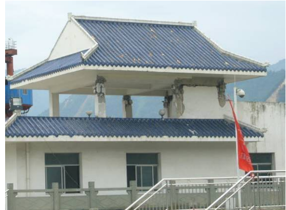
照片 4 水庫壩頂房舍受地震剪力作用導致結構受損。
