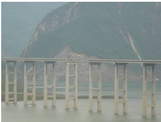
照片 5 都汶高速公路跨紫坪鋪水庫廟子坪大橋因地震造成中間橋板斷落水庫。
