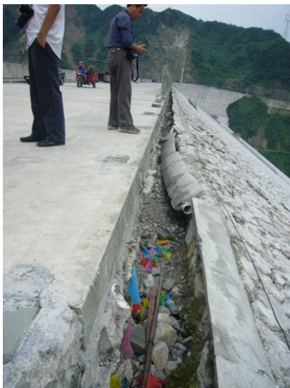
照片 3 水庫壩頂外側護欄震落於下游背水坡面，大壩中央下陷約 70 公分，向下游面外移約 30 公分。
