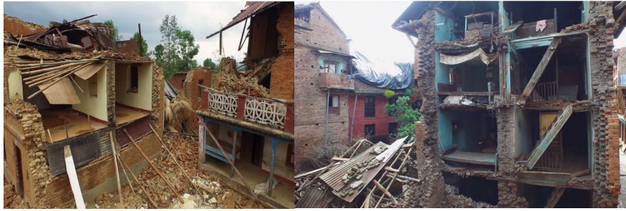
圖 8：受損房屋多屬耐震能力不足之建築
