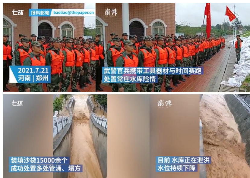
圖 7 鄭州市常莊水庫管湧危機處置情形 圖資來源[27]
