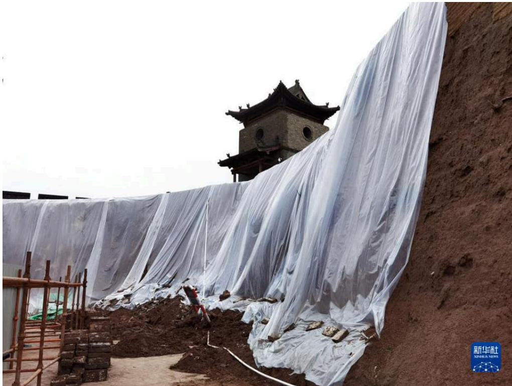
圖 7. 10月8日所拍攝的平遙古城城牆坍塌處理情形。(照片來源:新華社[12])
