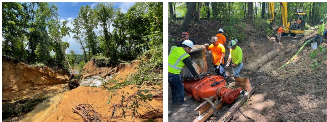
圖 10 阿拉巴馬州塔斯卡盧薩地區自來水主幹管遭洪水沖毀，風災過後隨即進行修復工程。(資料來源：Tuscaloosa News) [15]。
