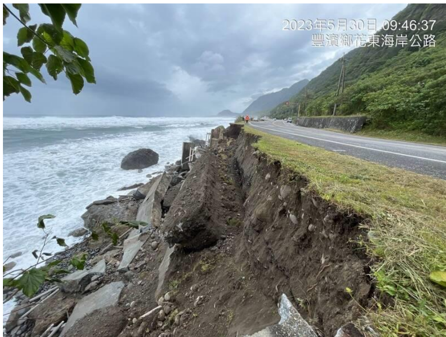
圖 3、花蓮縣豐濱鄉台 11 線 56.7K 路基遭浪襲掏空情形(資料來源：豐濱鄉公所)
