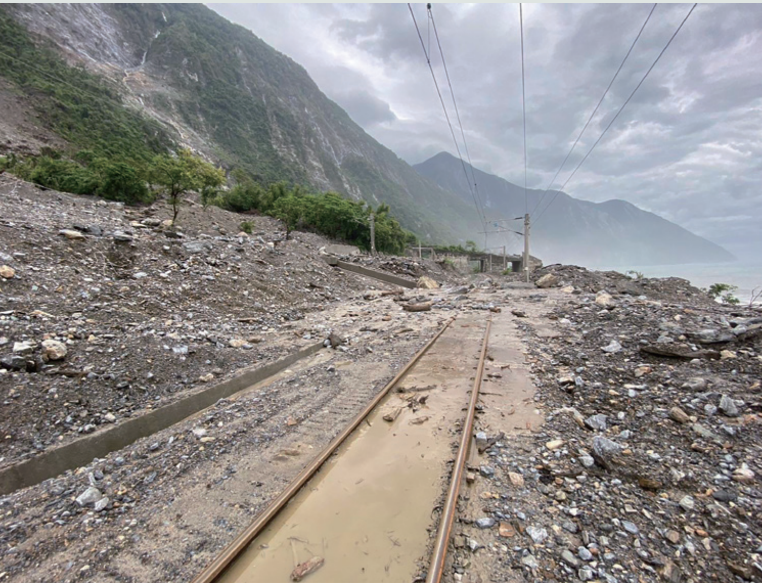
臺灣花蓮和仁至崇德段的鐵軌遭土石掩埋（資料來源：國營臺灣鐵路股份有限公司）
