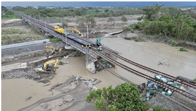
臺鐵縱貫線八掌溪橋（南靖＝後壁）K306+950 處，受溪水暴漲影響，路基遭沖刷約 30 公尺（資料來源：公民回報）
