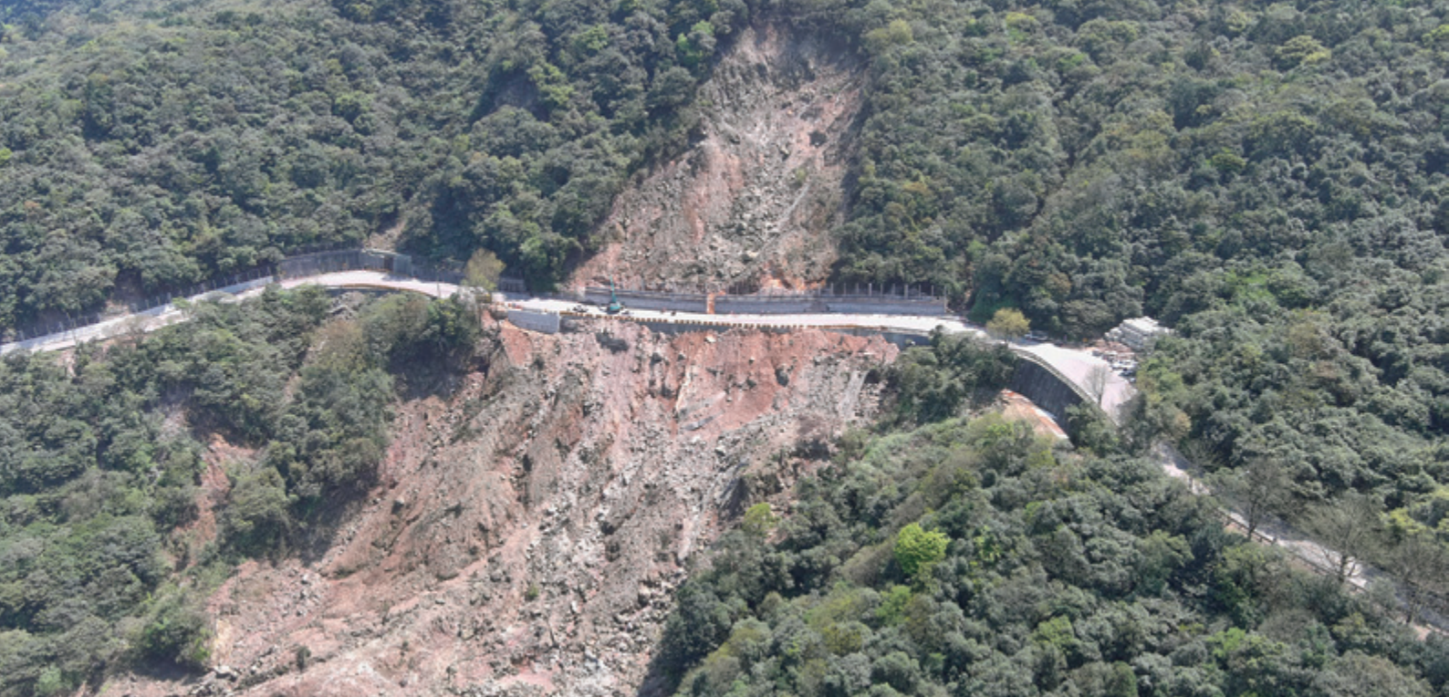
臺 2 甲 8.4K 舊有崩塌地再次擴大情形（資料來源：災防科技中心拍攝）
