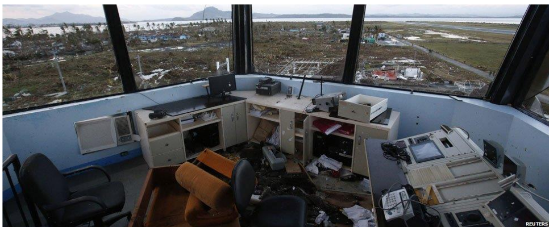
圖 8. 塔克洛班市機場毀損 9
