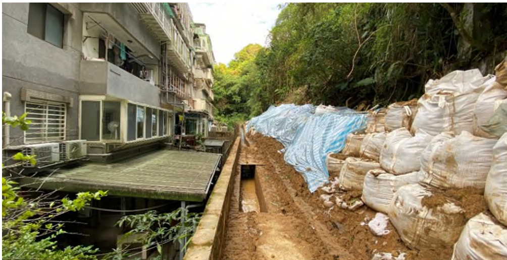
圖 2.3.21、2025 年 10 月 30 日勘災團隊於景華山莊附近拍攝受災民宅後方排水溝情形(資料來源：災防科技中心)
