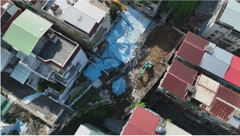
圖 2.3.16、2025 年 10 月 30 日勘災團隊於錦秀山莊附近拍攝受災情形(資料來源：災防科技中心)
