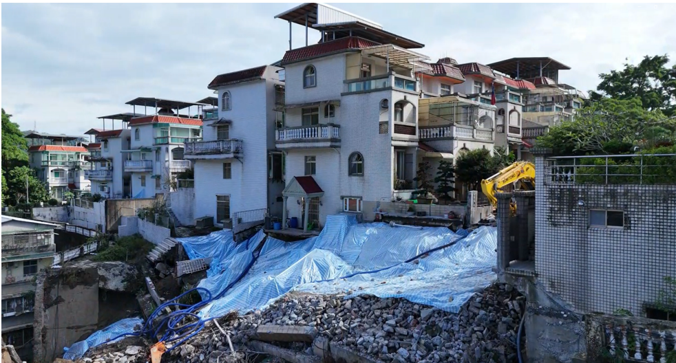
圖 2.3.15、2025 年 10 月 30 日勘災團隊於錦秀山莊附近拍攝受災情形(資料來源：災防科技中心)
