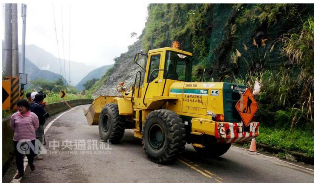
圖 2.21 台 21 線 115.54 公里坍方照片（資料來源：公路總局提供中央社記者）[20]
