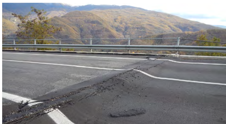
▲ SS685 公路橋梁毀損情形
