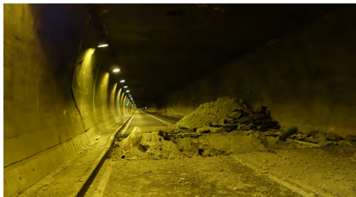
▲ SS685 公路隧道毀損情形
