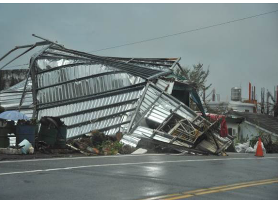
▲ 鐵皮房屋損毀
