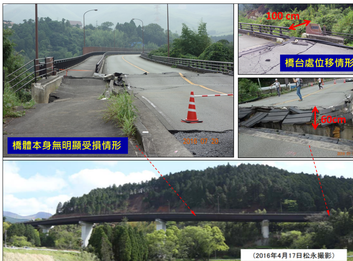
▲ 大切畑大橋橋體受損情形（資料來源：日本國立研究開發法人產業技術綜合研究所、災防科技中心）
