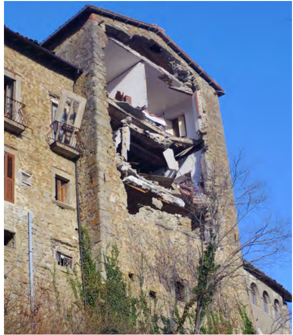
▲ Arquata 大量磚造石造之歷史建物嚴重毀損 (資料來源：災防科技中心)
