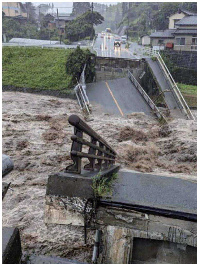
2023 年 7 月 3 日，位於日本西南部的熊本縣山都町的一座橋梁因大雨中斷（資料來源：EPA/ 達志影像授權提供）
