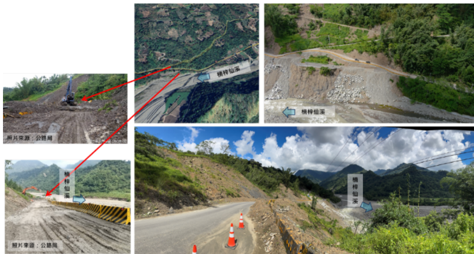
圖 3.2.4、台 29 線 4K+300 至 4K+800(三明火路段)路基流失
