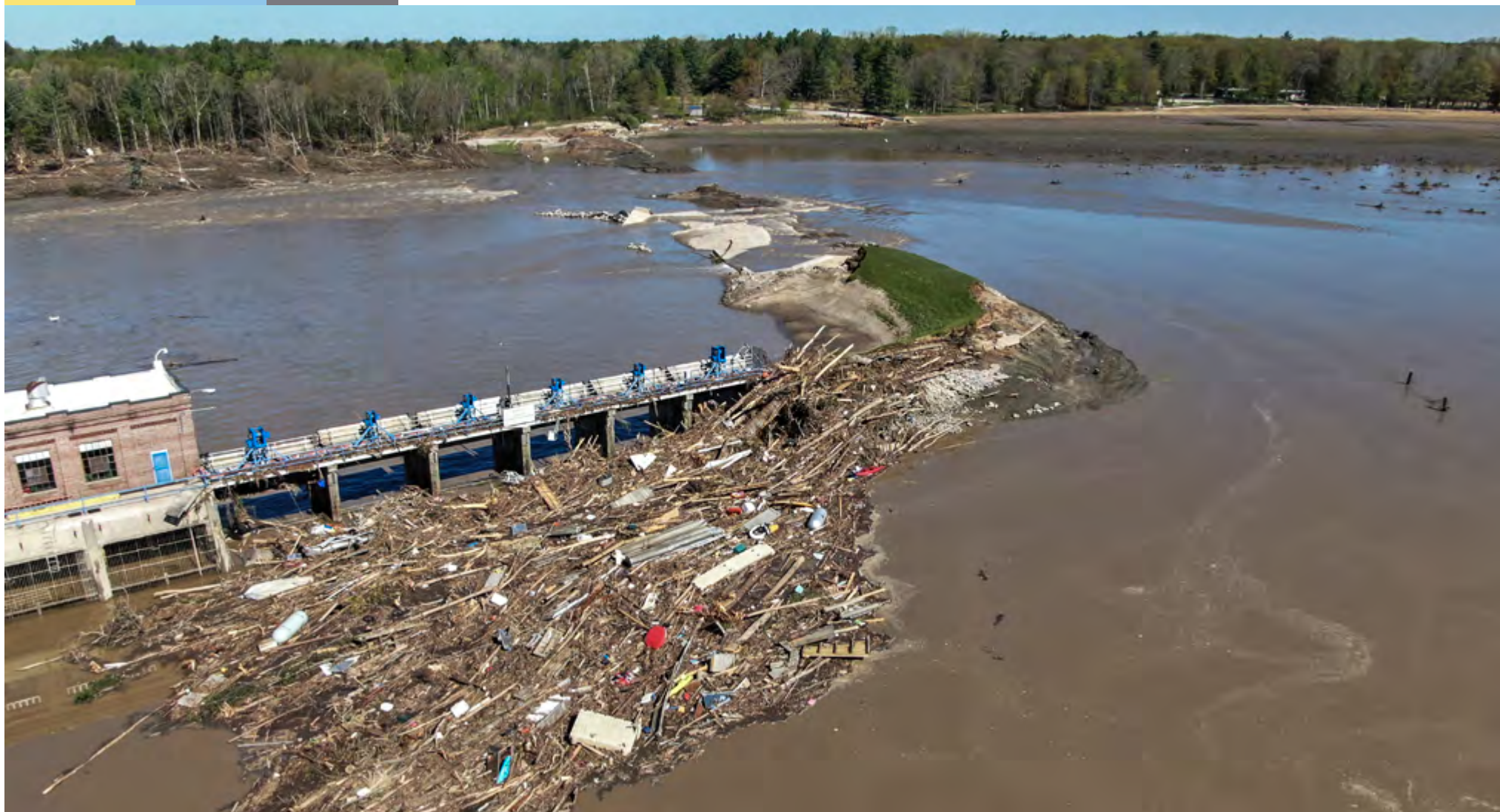
2020 年 5 月 21 日美國密西根州桑福德大壩 (Sanford Dam) 破壞情形 (資料來源：EPA/ 達志影像授權提供)
