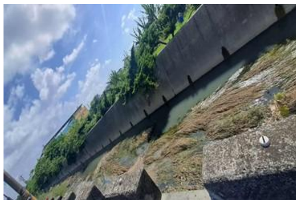
圖 3.3.4、彰化縣溪湖鎮埔鹽幹線災後現勘
