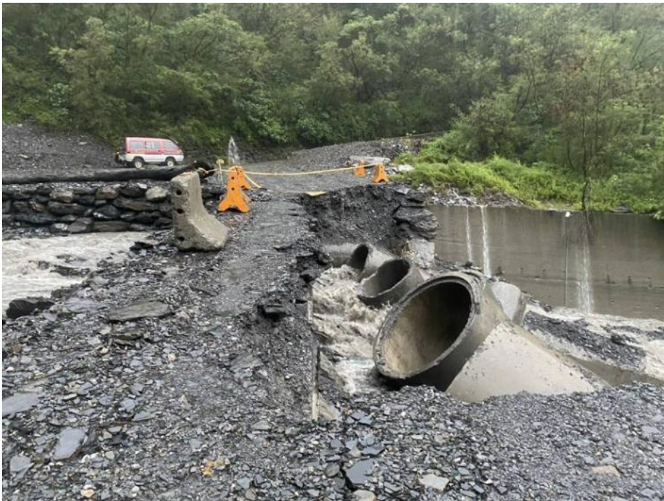
圖 6.2.2、霧大二號橋涵管遭洪水沖毀，橋面受損並縮減通行寬度，導致大武部落對外交通中斷(資料來源：聯合新聞網)[37]
