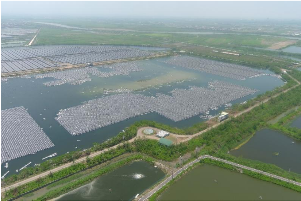
圖 2.3.5、嘉義縣布袋鎮新塭滯洪池光電板受損照片
