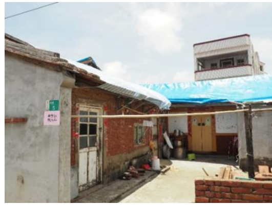
(b)西寮里大量屋頂遭強風吹毀，因此沿途可見多處臨時用帆布覆蓋的屋舍等待修繕(資料來源：災防科技中心)
