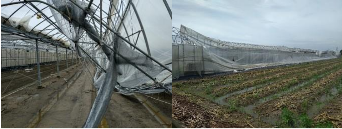
圖 2.4.4、丹娜絲颱風造成嘉義縣農業設施結構變形毀損(資料來源：災防科技中心)
