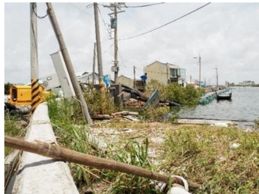
(h)西寮里社區周圍電桿遭強風吹倒的情形，台電人員仍在搶修中
