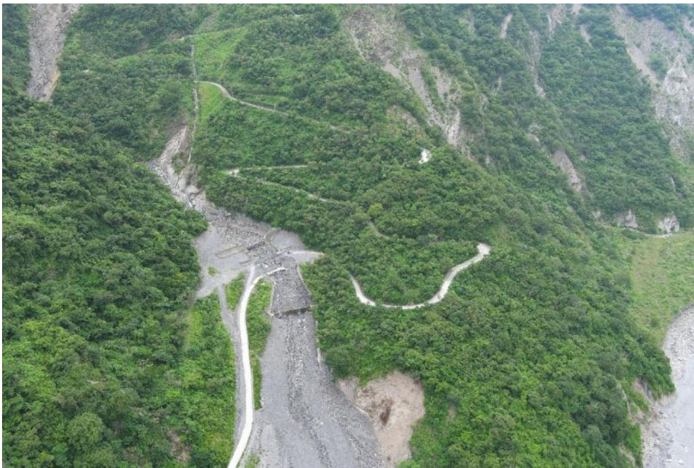
圖 6.2.5、霧台-大武聯絡道路調查照片(資料來源：災防科技中心 2025/07/25 攝)
