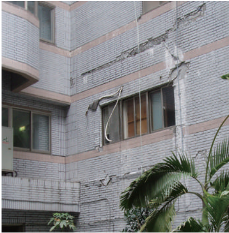
▲ 建築物外牆若有磁磚脫落或破裂，可能會發生滲、漏水現象，最好能盡速予以修補。
