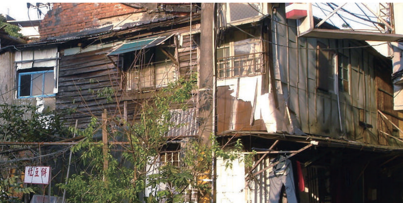
▲ 木造結構物耐震力較不佳，在地震時容易傾斜倒塌。
