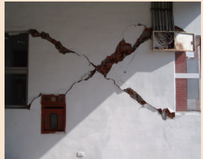
▲ 牆面若產生明顯的斜向裂縫、V 型或 X 型的裂縫時，應儘快進行補強，避免裂縫擴大而影響居住安全。
