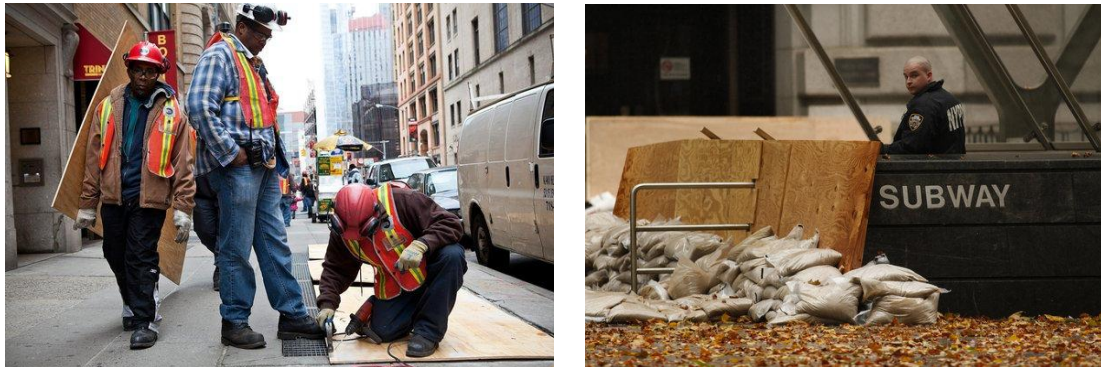
圖 12 紐約地鐵防護設施
