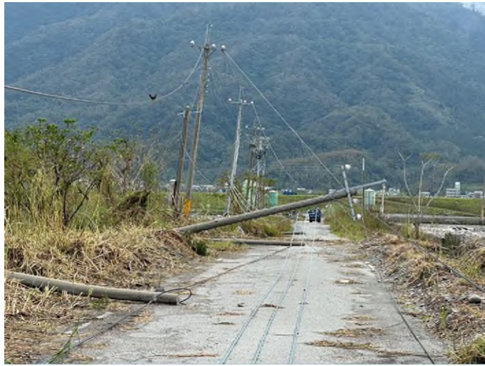
圖 2.2.1、康芮颱風於花蓮縣地區之電桿災損情形
