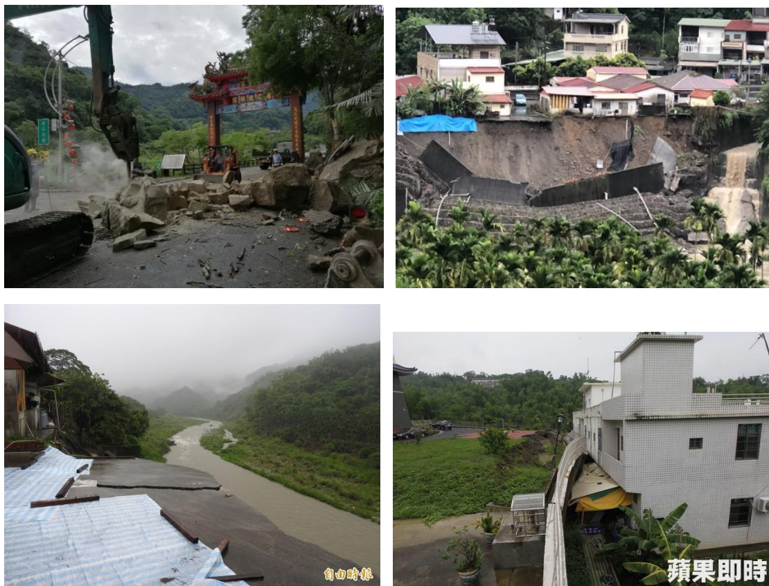
圖 8 坡地災情：烏石坑橋頭落石(左上)；柑林村護岸沖毀(右上)及臨時蓋帆布處置(左下)；旗山某佛寺擋土牆傾倒(右下)(圖源：今日新聞、自由時報、蘋果日報)
