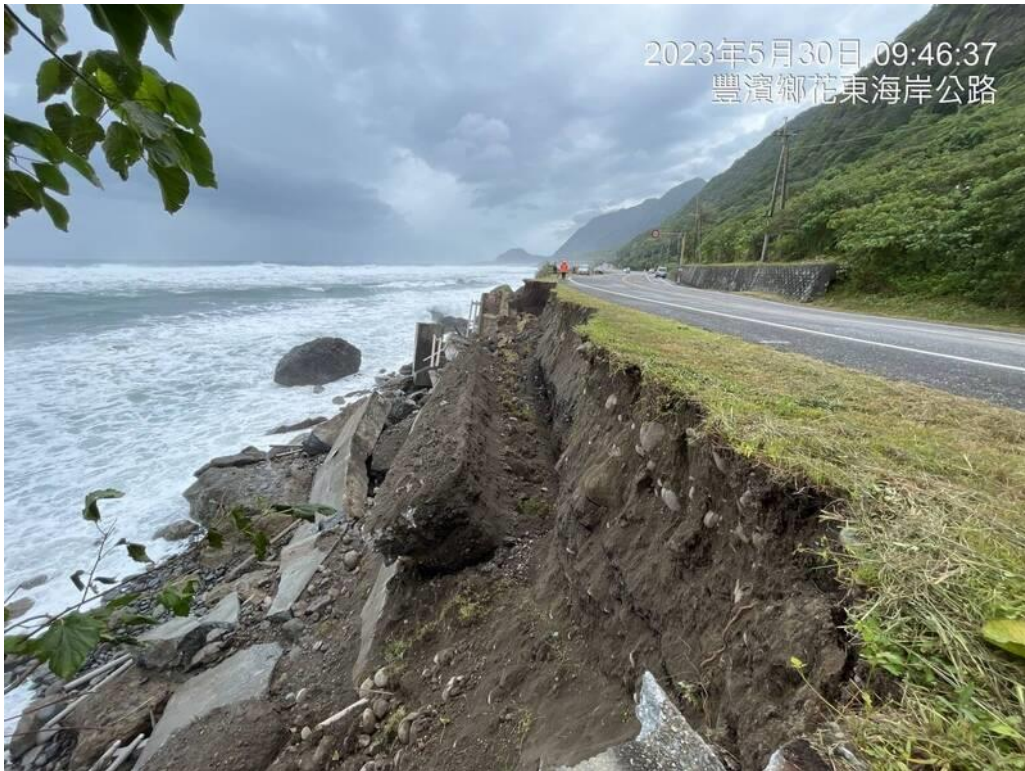
圖 2.9、花蓮縣豐濱鄉台 11 線 56.7K 路基遭浪襲掏空情形(資料來源：豐濱鄉公所)
