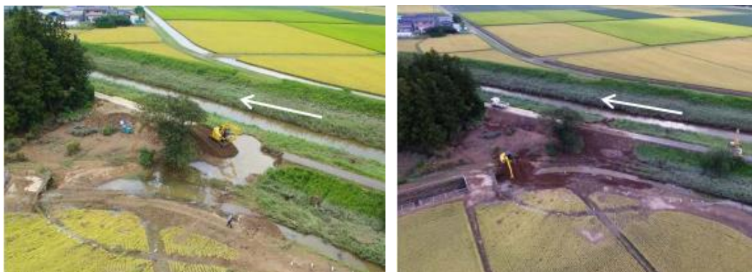
圖 6. 涉井川潰堤修復照片(東北地方整備局)
