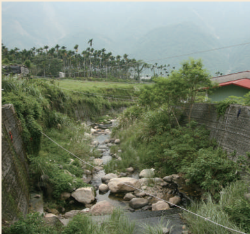
▲ 河道雜草叢生，使得河水宣洩受阻，可能會造成河道淤塞，並影響排水功能。
