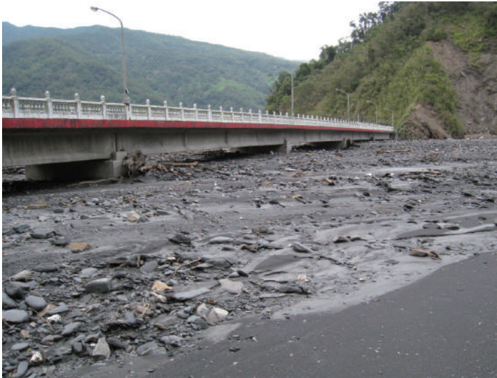
▲ 河床淤積後河川水位容易被抬升，並可能越過堤防向河床兩側溢流。
