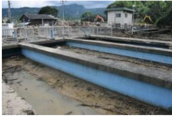
圖 14-朝倉市杷木浄水廠遭受破壞(資料來源：西日本新聞)
