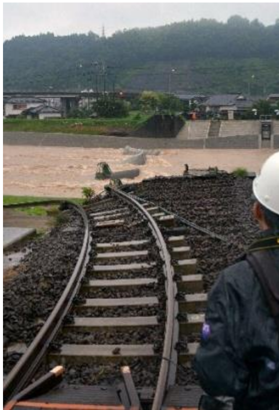
圖 12-大分縣日田市 JR 久大線鐵橋路基流失 80 公尺(資料來源：
