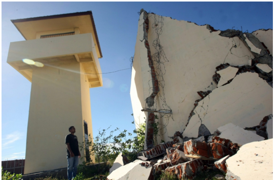
照片6-5 地震發生後一位監獄管理人員在的監獄外牆評估圍牆倒塌毀損情況。 照片來源:歐新社
