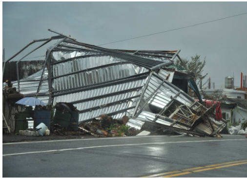
鐵皮房屋損毀
