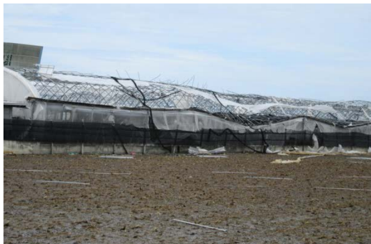
農業設施溫網室鐵管骨架彎曲
