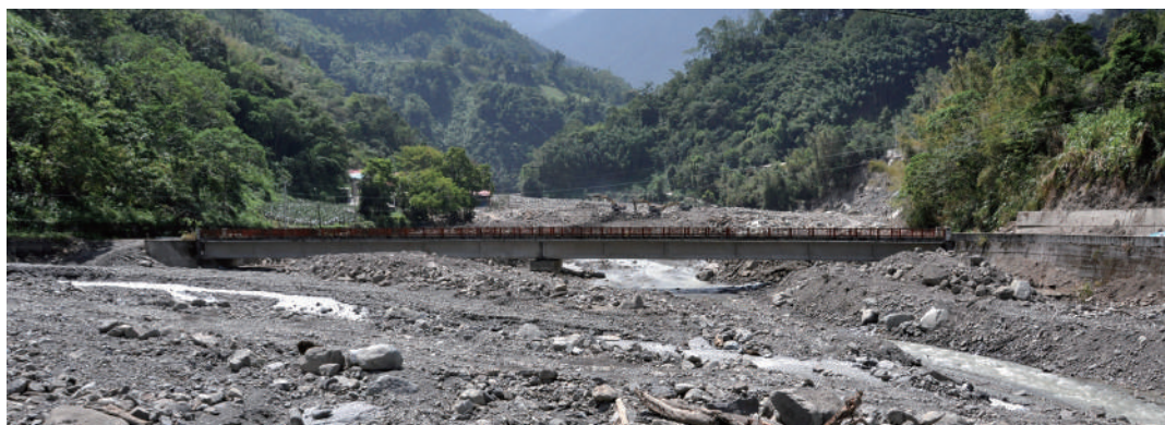
▲ 橋梁下方土石嚴重淤積，導致通水斷面不足，在颱風豪雨期間容易因溪水溢淹，造成交通中斷。
