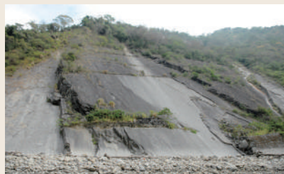
▲ 臺 24 線往高雄市那瑪夏區途中的順向坡路段，在莫拉克颱風侵襲期間發生滑動與崩塌災害。
