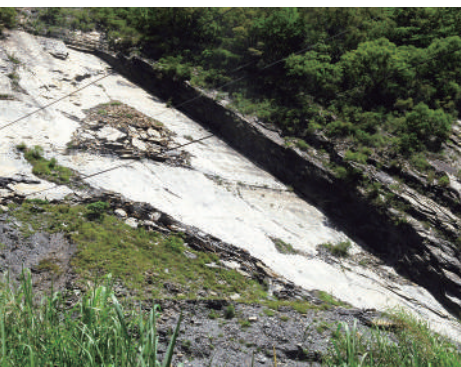
▲ 順向坡層面露出，雨水入滲後可能會造成滑動發生。
