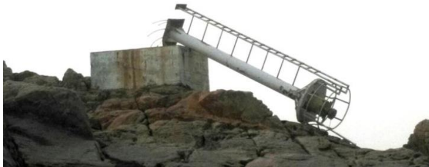
圖 37 鵲石導航太陽能燈塔，遭強風吹倒(馬祖日報)
