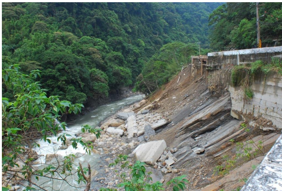
圖 28 北 114 線 6.2 公里路基坍塌
