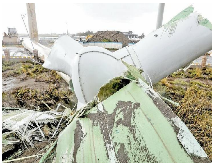
圖 34 高美濕地旁風力發電機損壞（資料來源：聯合新聞網 8/9）
